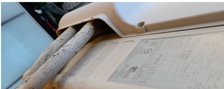
圖 4 冷氣室外機銅管保溫棉上塗抹一層矽利康
