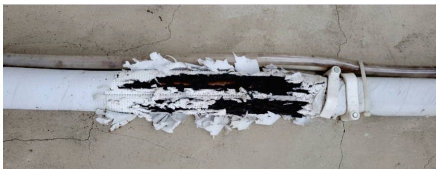
圖 3 分離式冷氣機室外銅管保溫棉破損
