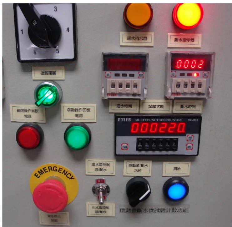
圖 26 循環通/斷水試驗控制盤
