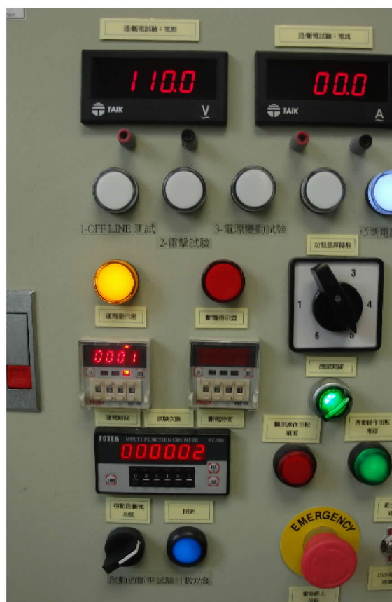
圖 27 循環通/斷電試驗控制盤
