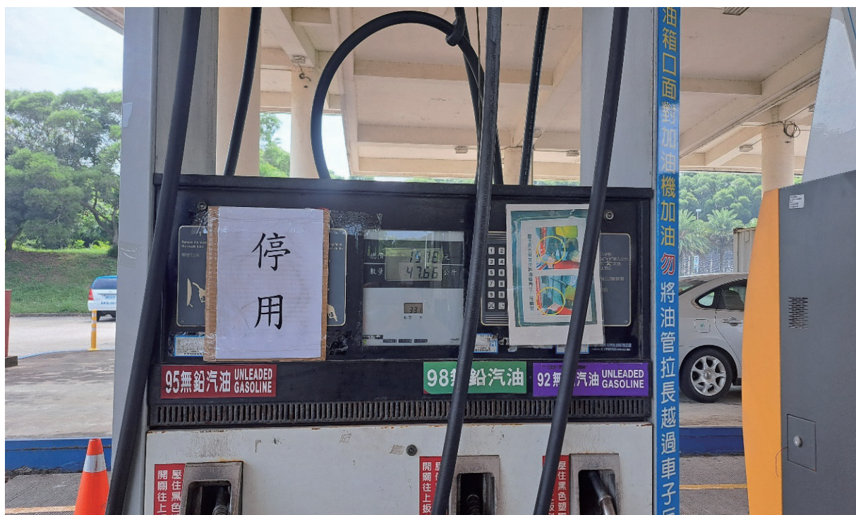
圖 1 油量計逾期貼停用標示圖例
