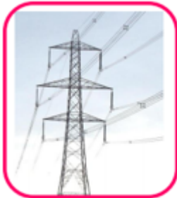
變電所 / 配電 / 饋線 自動化
