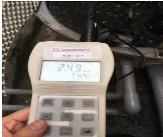
冷卻水塔未進行水質管理
