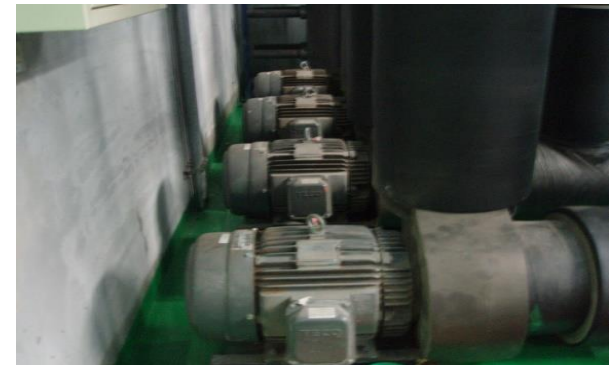
水泵未導入變頻控制
