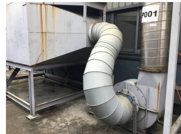
風管急彎壓損大
