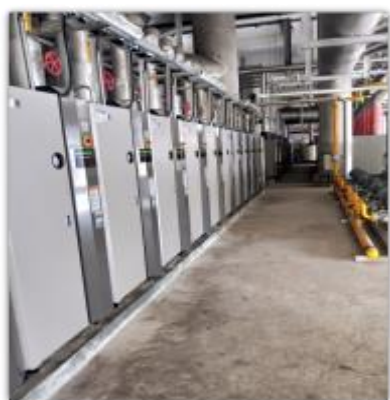
天然氣貫流式鍋爐(18台2.5噸)
