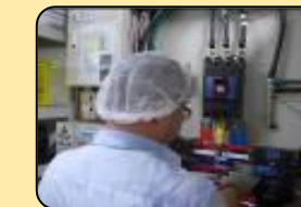
風機電力量測
