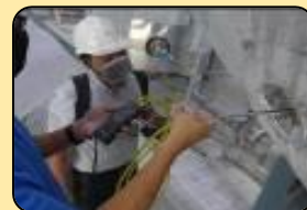
風機壓力量測
