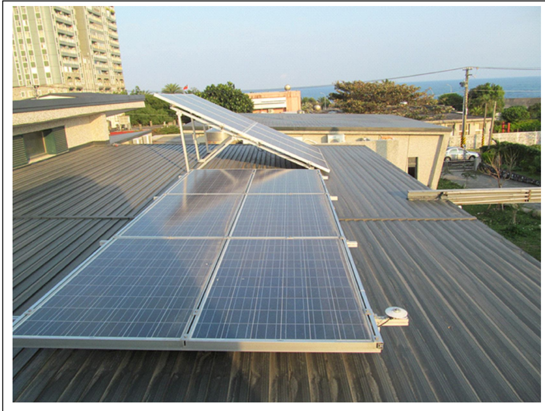
圖2 太陽能模組板一架設於化工實驗室屋頂呈5°、26°不同仰角
