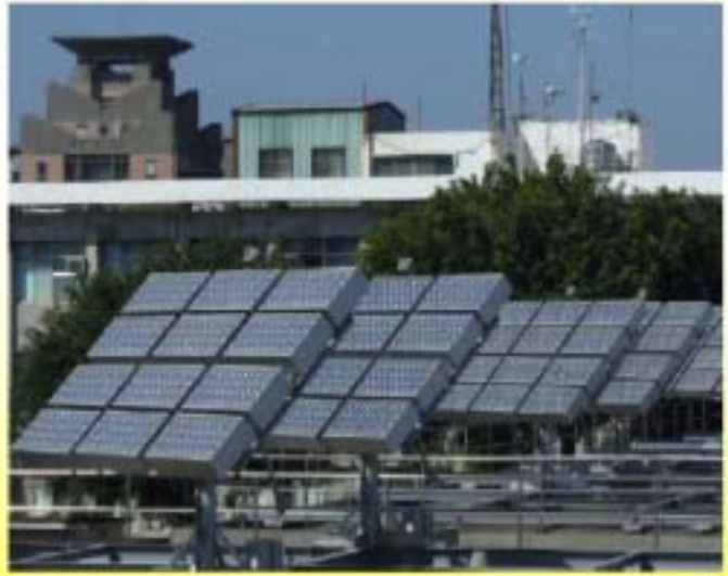
屋頂式1.5kW HCPV系統
