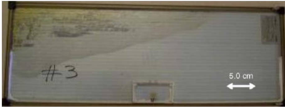
圖28 模組背面之介面剝落與水氣侵入的情形[9]
