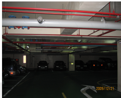
照明不良使停車場“暗”藏危機
