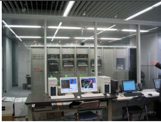
日本 NICT 控制室
