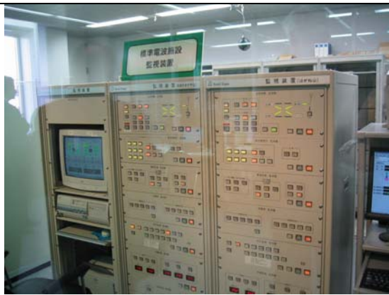
日本 NICT LF 監視設備
