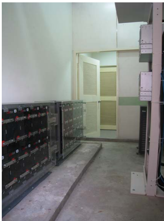
圖 1.6、實驗室直流電源系統電池組照片
