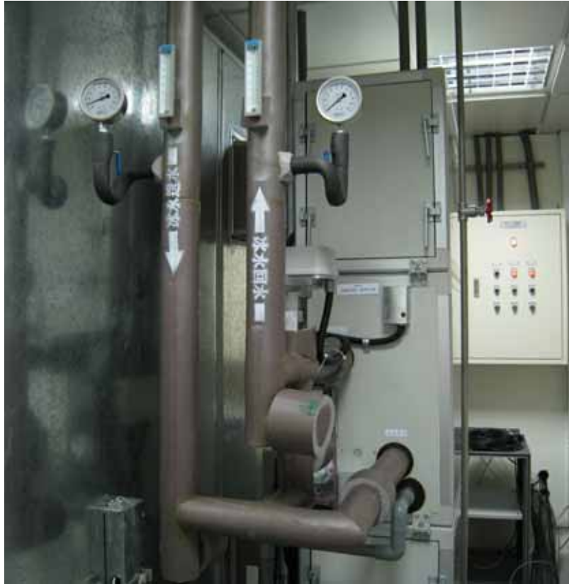
圖1.1.7 本實驗室原子鐘隔離室空調設備
