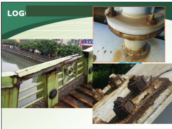
圖 1(a) 鋼鐵材料腐蝕
