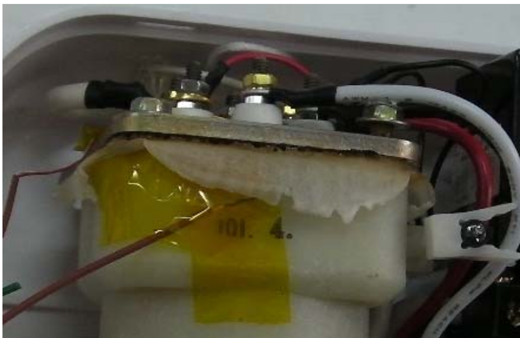
圖 4 熱水膽與加熱器金屬外殼接合處產生熔出物
