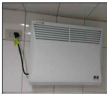
f.壁掛浴室實照
