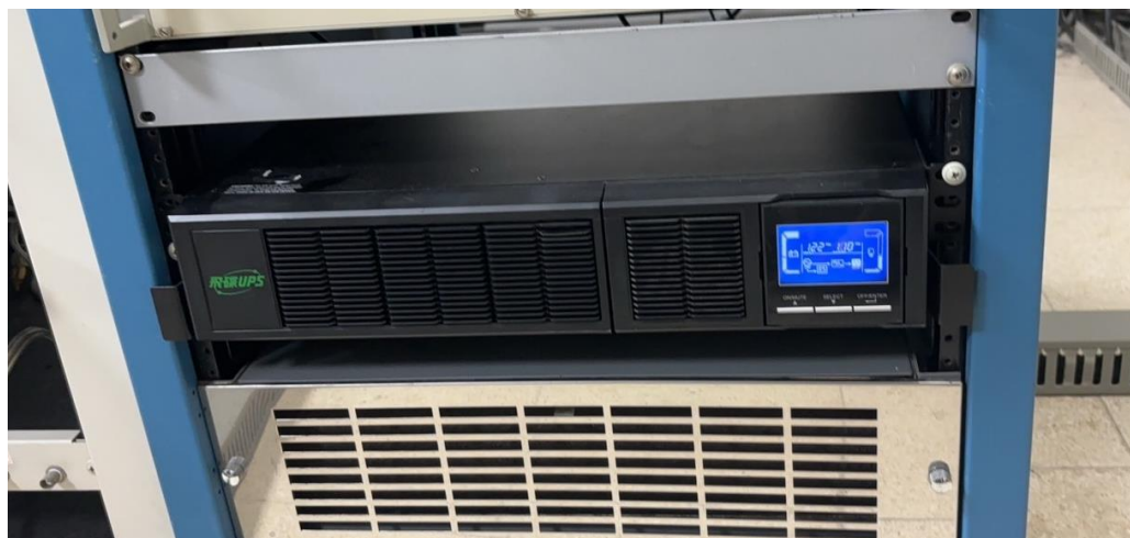
圖 34、實驗室及頂樓電源連接 UPS 共同輸出電源
