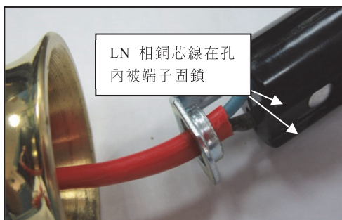
(c)4.7 節燈座提供電線芯線固定孔，銅絲無外露
